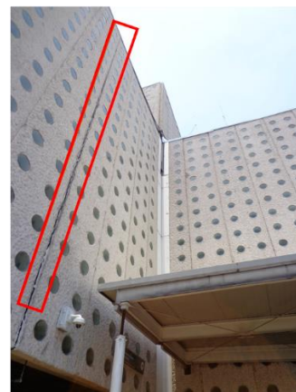
Grieta en paneles de concreto del Dedo Sur
