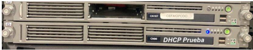
Figura 14. Vista Frontal de los 2 equipos "Calamar", y el firewall.
